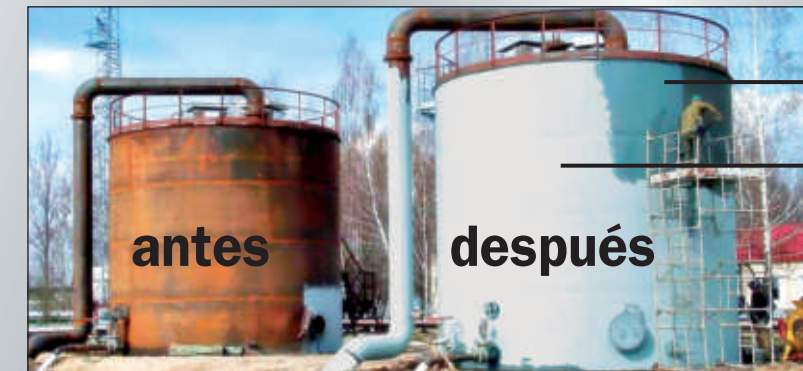
Estación de bombeo de petróleo en Kobrin - Belorusia
